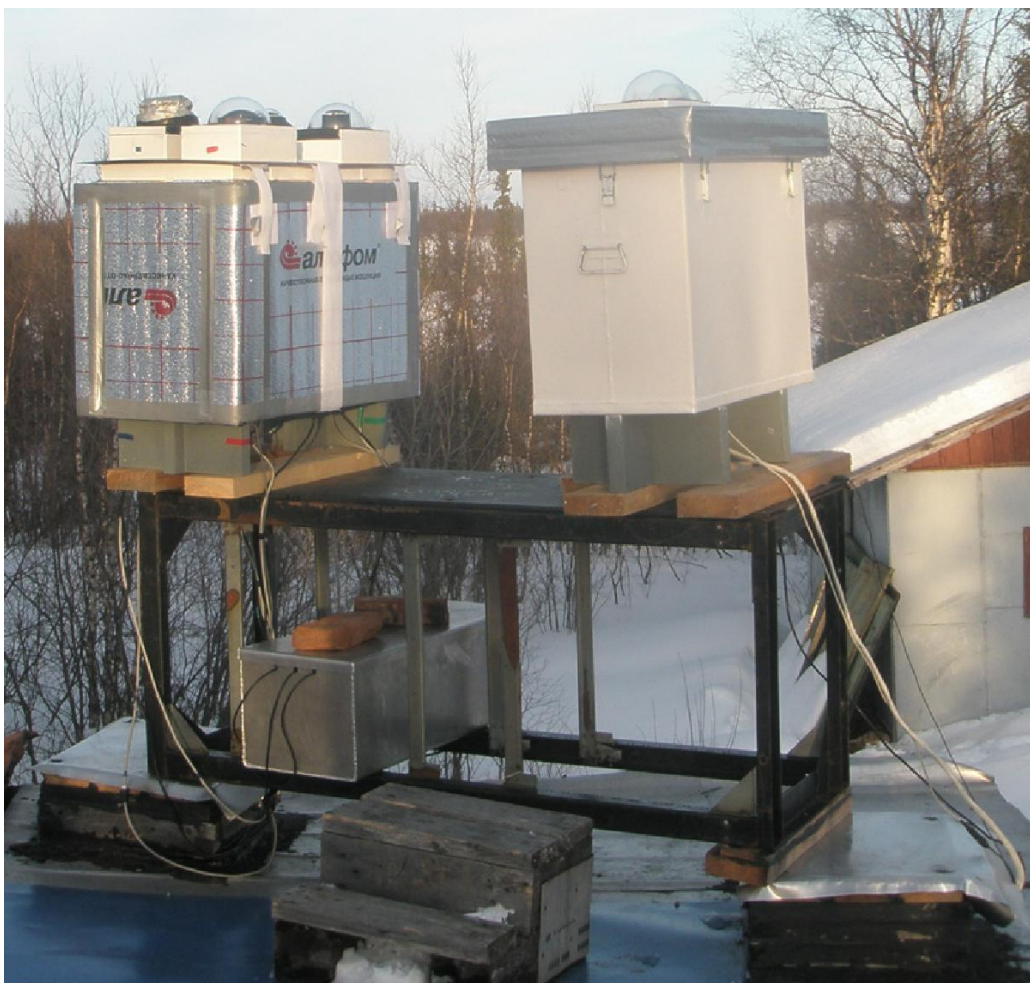
Гермобоксы меридионального спектрометра (справа) и эмиссионного имажера (слева) на крыше оптического павильона в obs. "Ловозеро"
